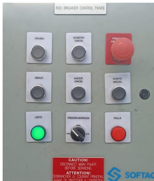
Imagen 1 Panel de control rod breaker
